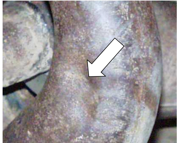
Einschlag durch scharfkantigen Felsen. Blech ist geknickt.
